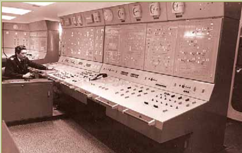
Пульт управления паротурбинной установкой
