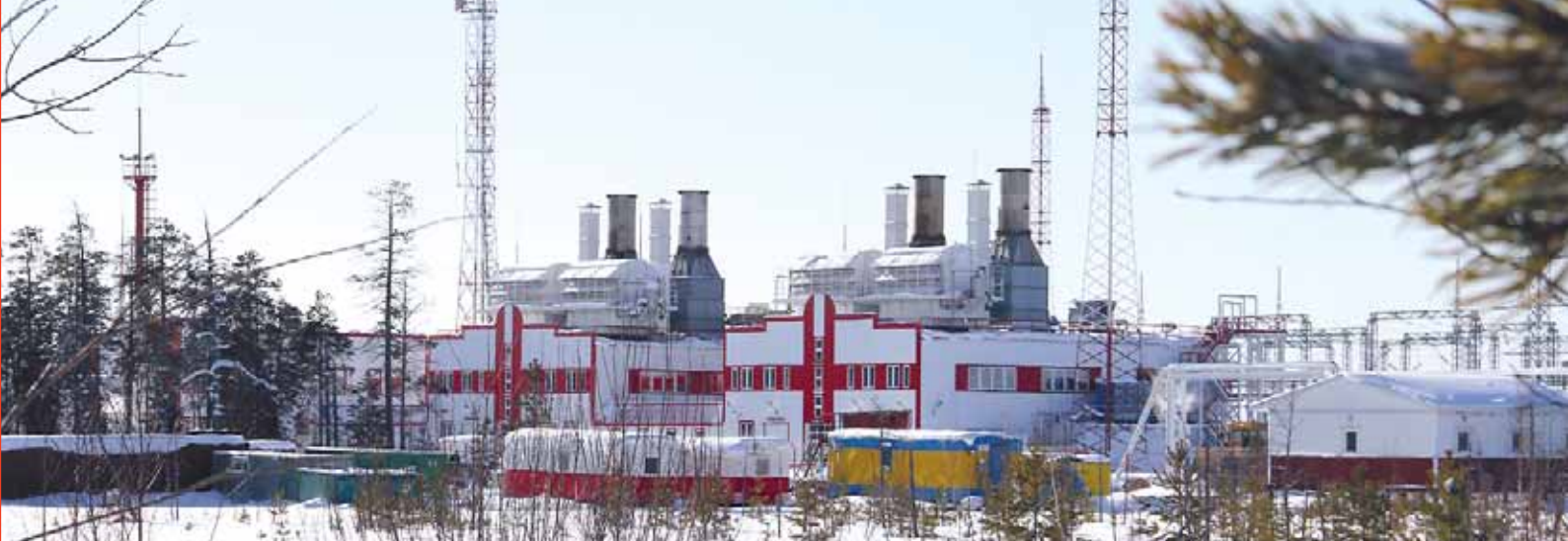
Покачевская ГТЭС-48 на базе пермских газовых турбин. ООО "ЛУКОЙЛ-Западная Сибирь"
