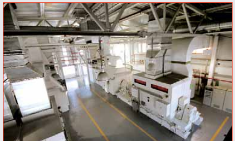
Машинный зал. Повховская ГТЭС-48
